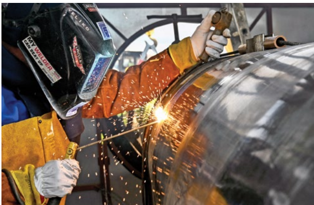
Рабочий сваривает трубу на газопроводе Болгария–Сербия недалеко от Костинброя, Болгария. Февраль 2023 г. Этот долгожданный соединительный газопровод призван повысить безопасность поставок газа в регионе. AFP/GETTY IMAGES
