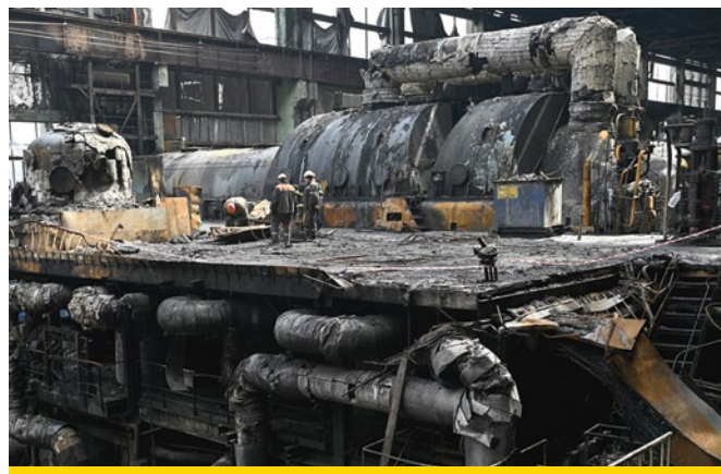
Рабочие расчищают обломки в турбинном зале украинской электростанции, разрушенной в результате российского обстрела в апреле 2024 г. Россия продолжает регулярно наносить удары по энергетическим объектам Украины.
